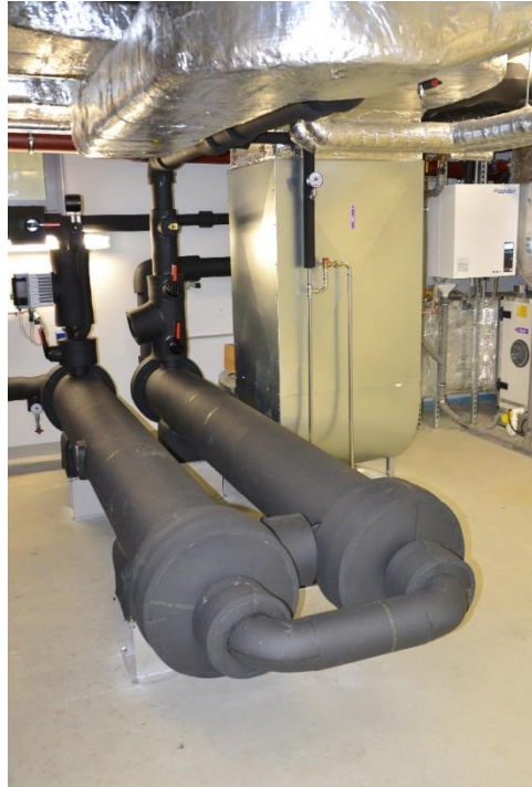
Abbildung f: Blick in die Heizzentrale der HS Kaiserslautern: Röhren-Wärmeübertrager und Wärmepumpen bringen das aus der Tiefe geförderte Lauterwasser auf eine Vorlauftemperatur von 45 Grad
