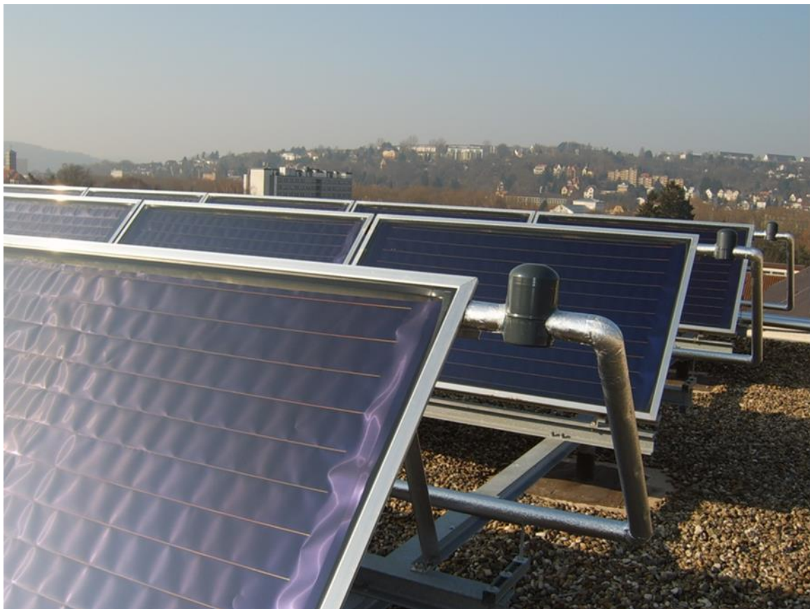
Abbildung w: Solarthermieanlage Justizvollzugsanstalt Zweibrücken
