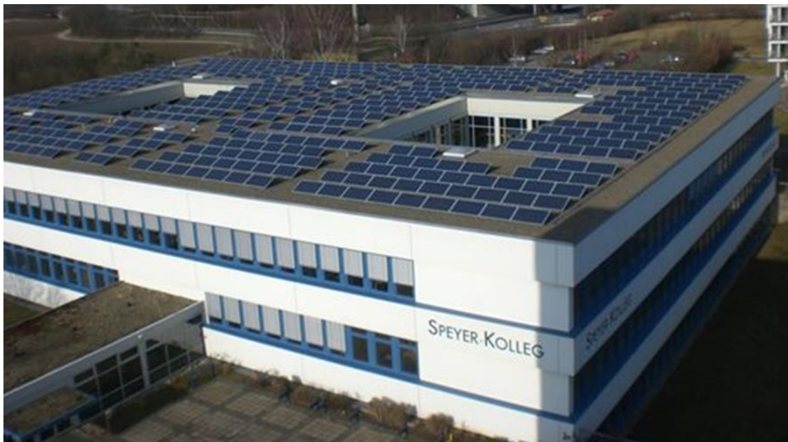
Abbildung v: Photovoltaikanlagen auf dem Pädagogischen Landesinstitut in Speyer
