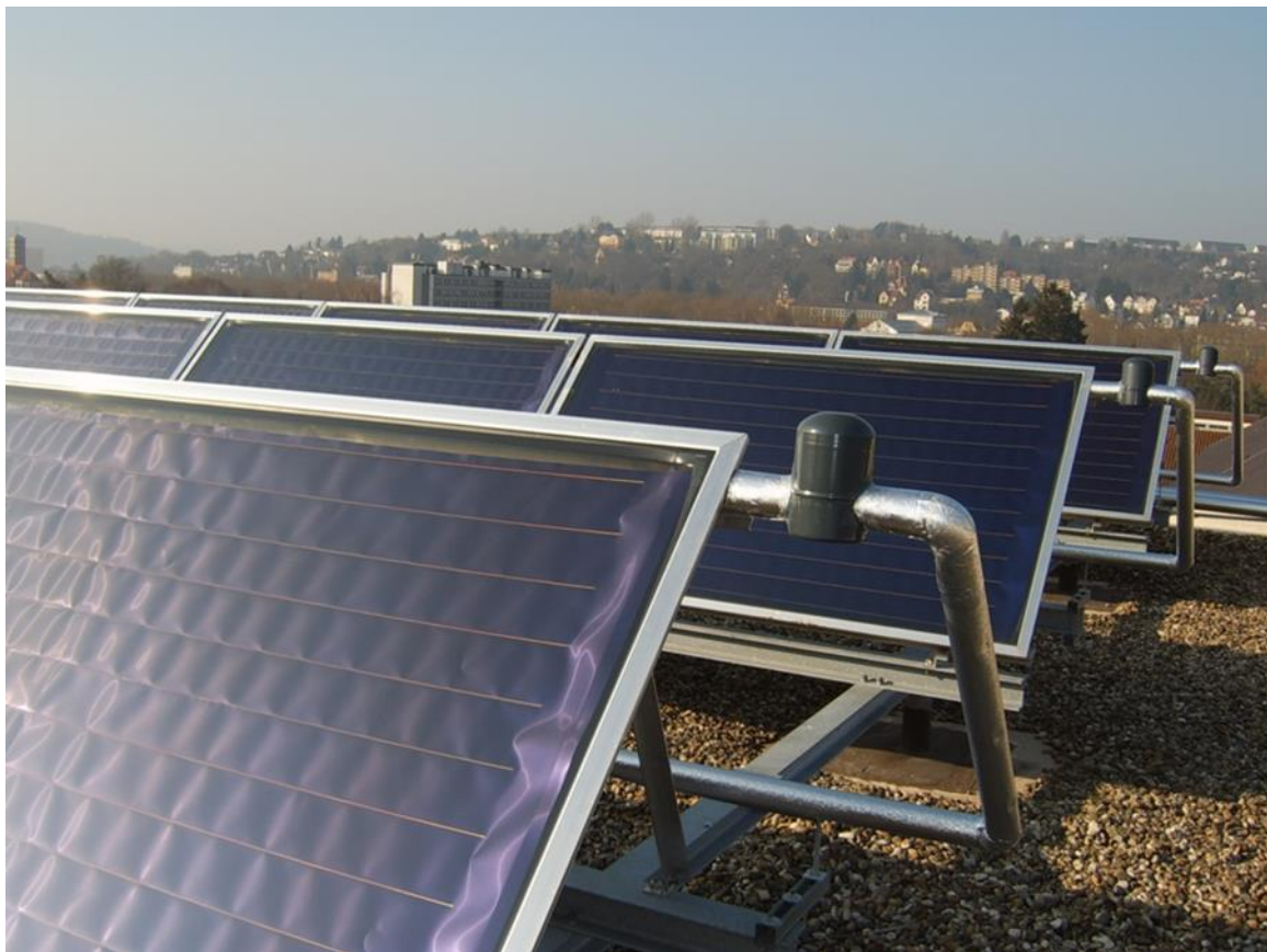
Abbildung w: Solarthermieanlage Justizvollzugsanstalt Zweibrücken
