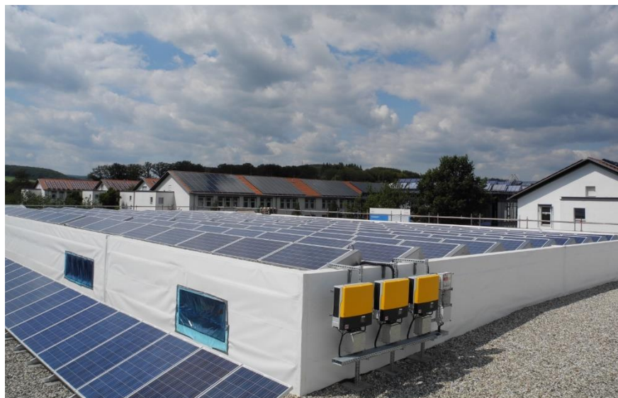
Abbildung c: HS Trier, Umwelt-Campus Birkenfeld, PV-Anlage Kommunikationszentrum
