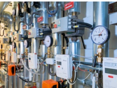
Heizungsverteiler mit Wärmemengemesser
