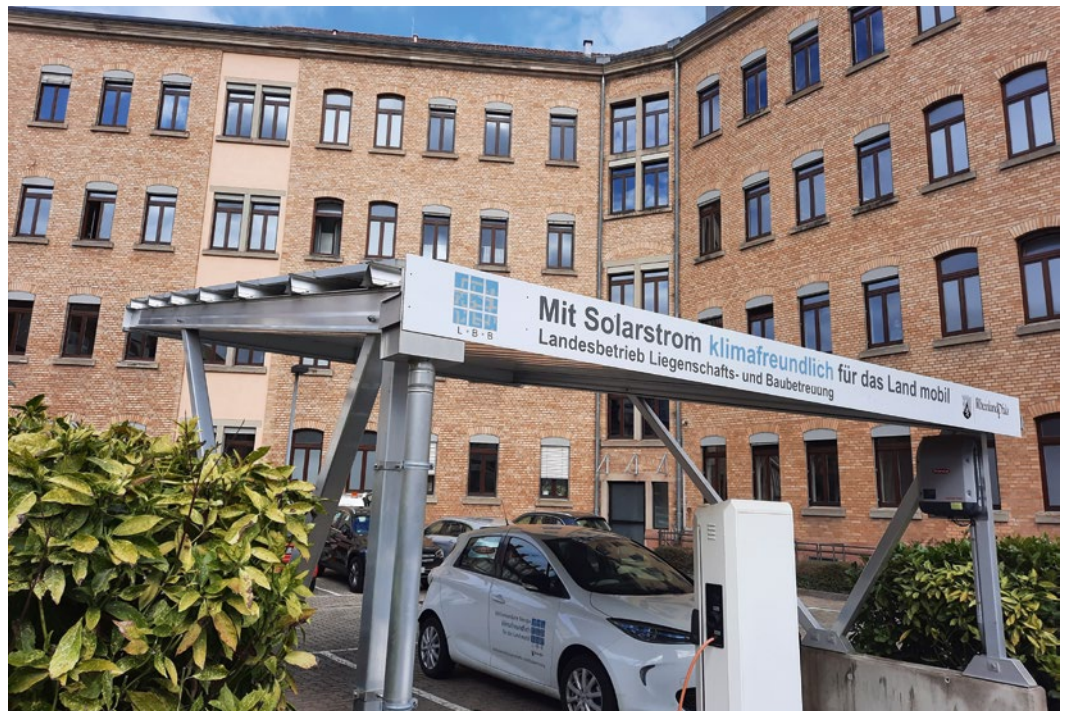
Solar-Carport mit Ladestation für die E-Dienstfahrzeuge der LBB-Niederlassung Landau
