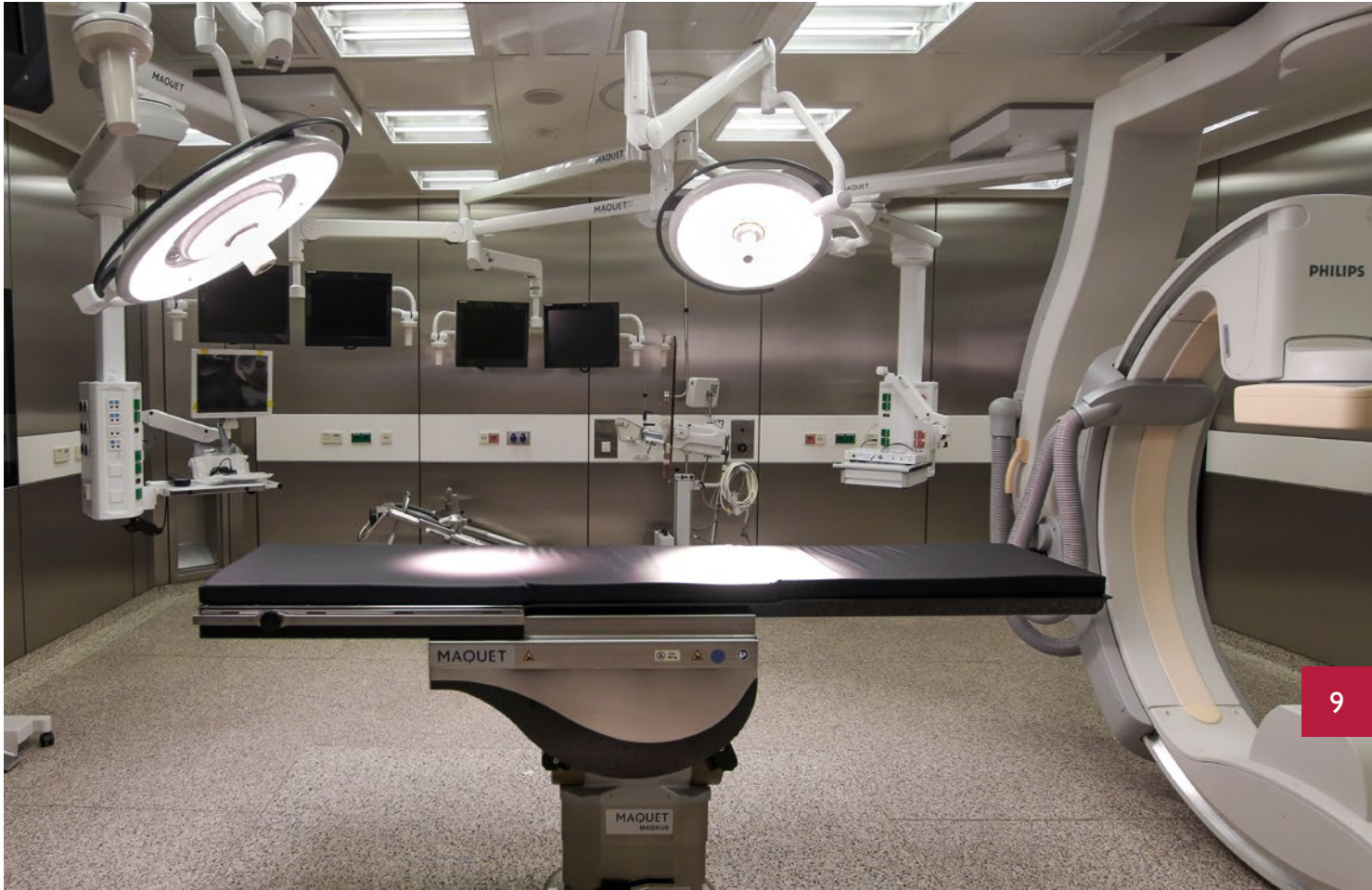
Umgebauter Hybrid-OP-Saal im Bundeswehr-Zentralkrankenhaus, ausgestattet mit stationärem Röntgengerät und besonderen Klimabedingungen für Verbrennungsoffer
